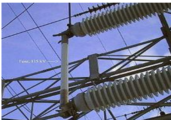
Рисунок 6.3 – Високовольтний запобіжник в ланцюгу 115 кВ
